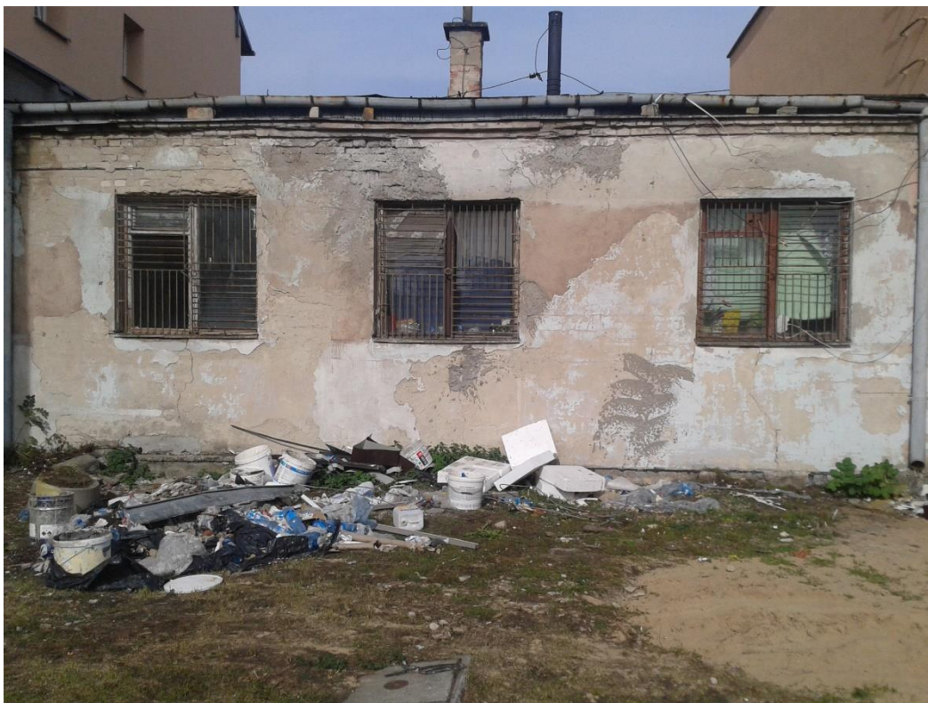
Zdjęcie 3. Zdegradowany budynek na terenie byłego PGR w Ogorzelicach
