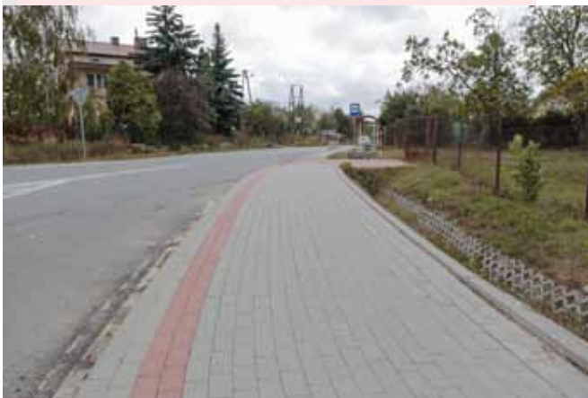
Budowa chodnika od drogi wojewódzkiej wzdłuż drogi powiatowej Nr 6905W relacji Parzeń – Kamionki – Stara Biała – granica Miasta Płocka na długości 360 mb Realizacja 2015 Dofinansowanie dla Starostwa Powiatowego - 221 600,00 zł - wysokości 50% wartości wykonanych robót.
